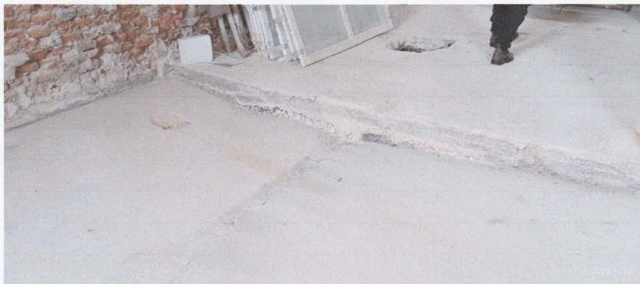
(Snímka F1 - záber od popraskanej podlahy smerom ku silno poškodenej podlahe)
