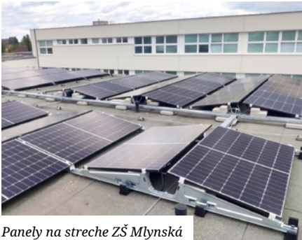
Panely na streche ZŠ Mlynská
